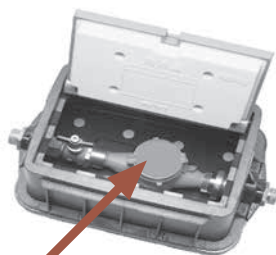
水道メーター(量水器)
