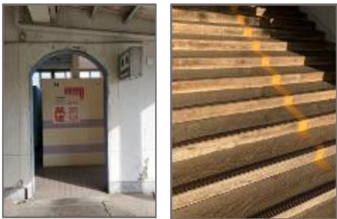
図表 老朽化しているトイレ（改札外）とホーム内にある階段
