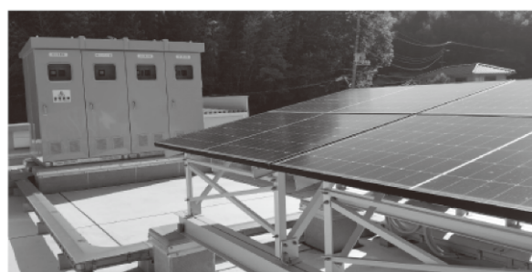
麻里府公民館の太陽光発電施設
