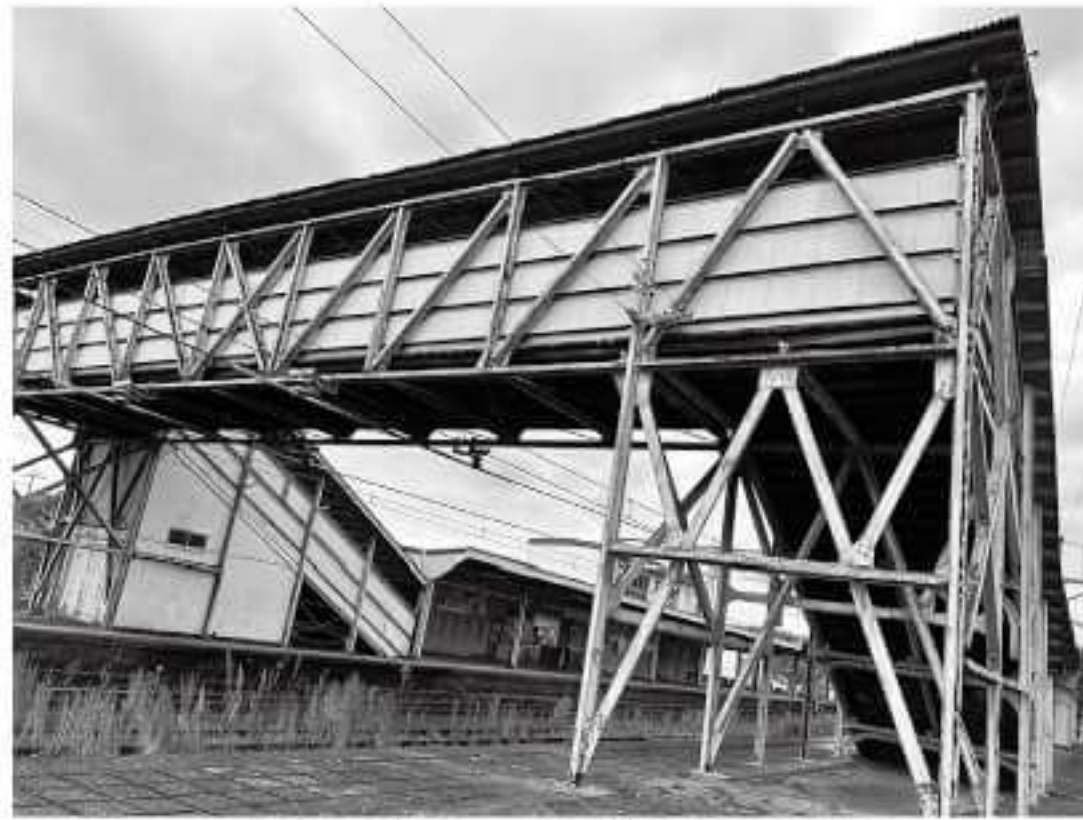
老朽化が目立つ田布施駅の跨線橋
