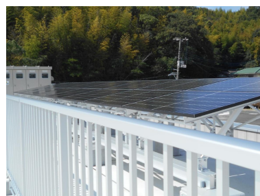
屋上に設置されたソーラーパネル
