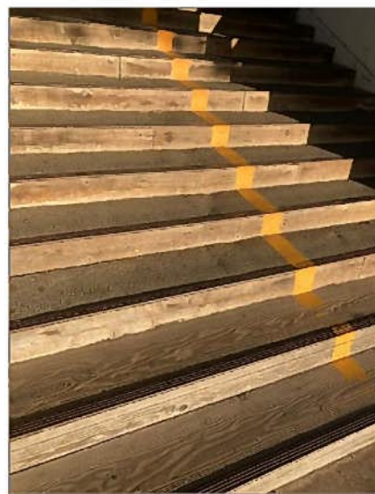
図表 老朽化しているホーム内にある階段
