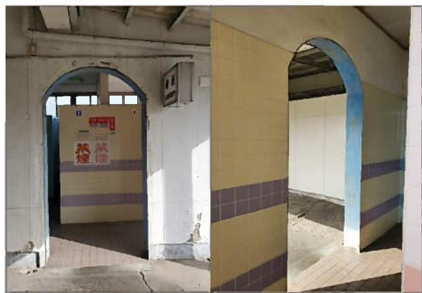
図表 老朽化しているトイレ（改札外）
