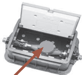
水道メーター（量水器）
