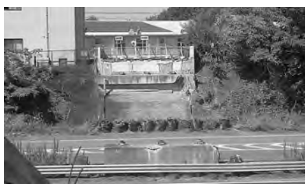
落下した跨道橋跡(甲佐町の九州自動車道)
