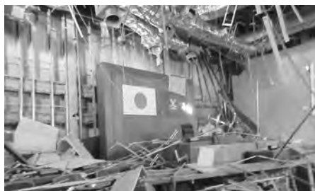
天井が崩落した議事堂(益城町)
