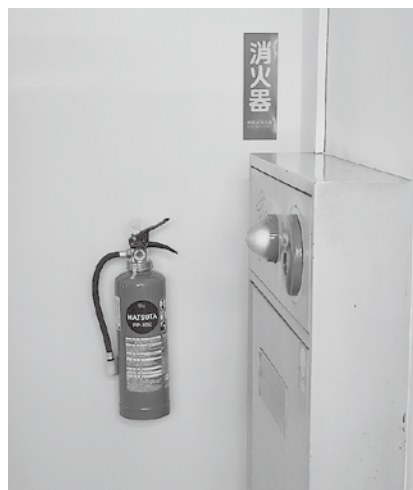
庁舎1階に配置の消火器
