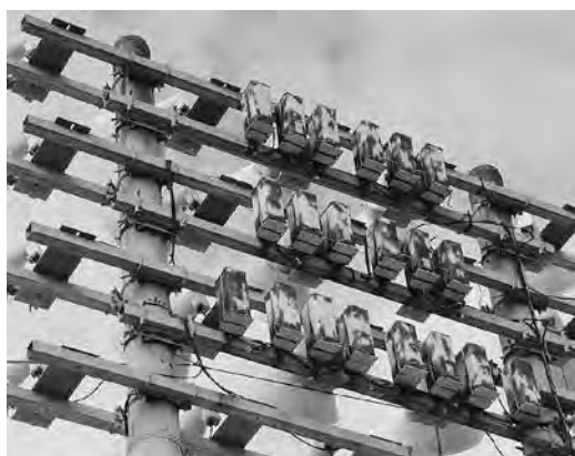
錆だらけの安定器（照明灯の裏側）
