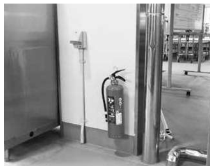
消火器（給食センター）
