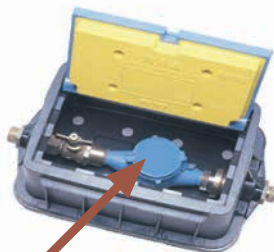
水道メーター(量水器)
