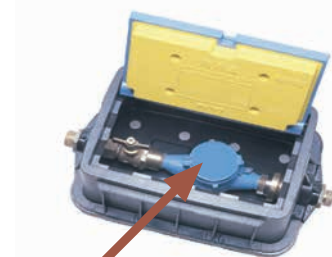
水道メーター（量水器）
