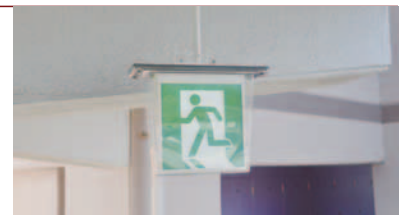
町営波野団地住宅に設置された誘導灯
