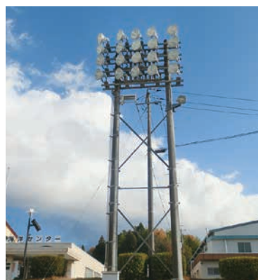
スポーツセンター夜間照明
