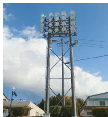
スポーツセンター夜間照明
