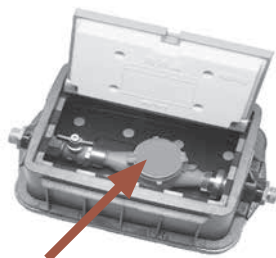
水道メーター(量水器)
