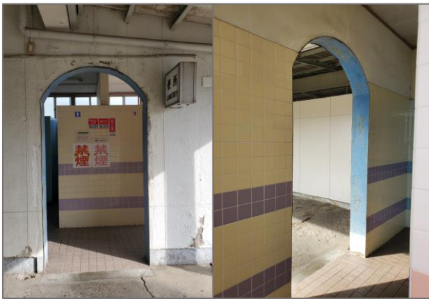
図表 老朽化しているトイレ（改札外）
