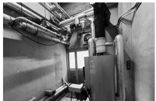
老朽化した空調設備(麻里府保育園)
