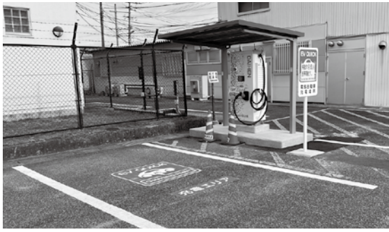
電気自動車充電設備
