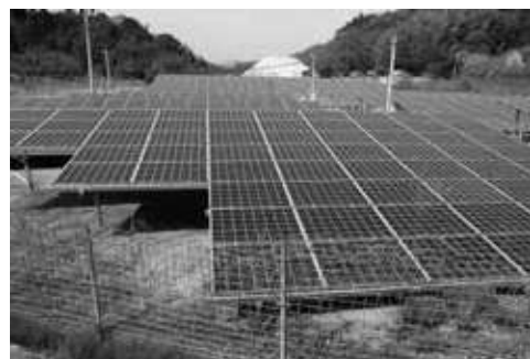
太陽光発電設備
