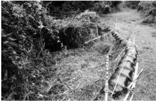
崩れた登山道の路肩(要害山)
