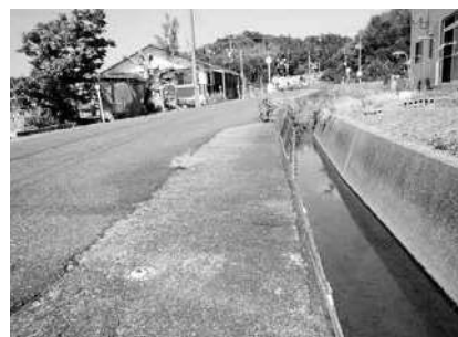
町道路肩危険箇所の一例
