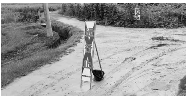
災害現場(町道蔵本線)
