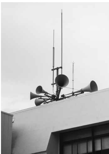
庁舎屋上のスピーカー
