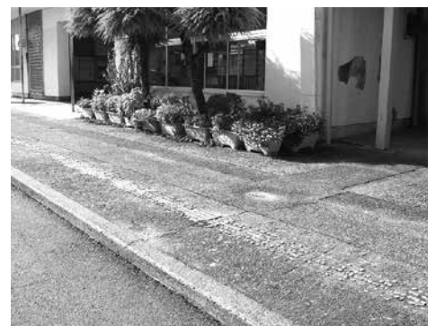
劣化した点字ブロック
