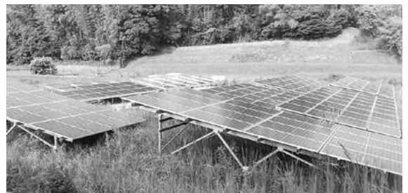
太陽光発電施設
