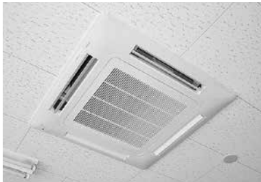
中学校のエアコン
