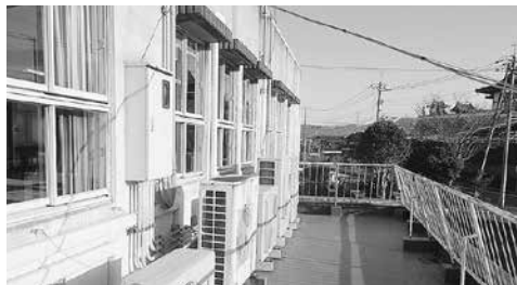
老朽化した中央公民館
