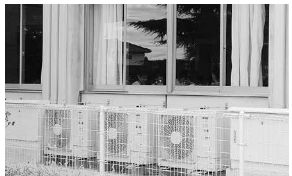
中学校のエアコン
