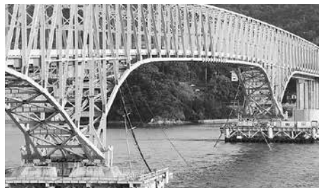
送水管が垂れ下がる大島大橋
