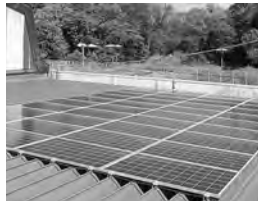
スポーツセンター太陽光パネル
