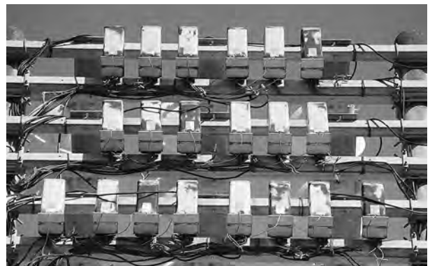
町民グランド照明(錆付いた箇所も見られる)
