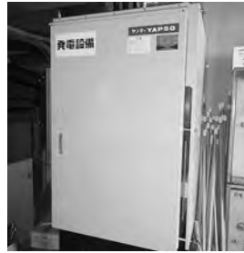
非常用発電機
