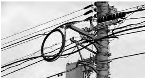
光通信ケーブル
