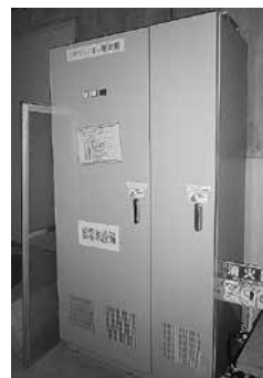
TAIKOスポーツセンターのバックアップ電源
