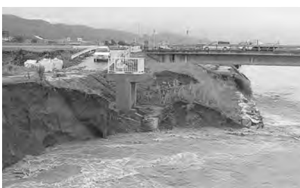
9年前の関戸橋付近の崩壊現場
