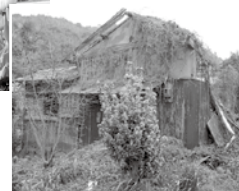
倒壊しそうな住宅
