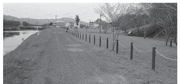
未舗装の詩情公園前の道路
