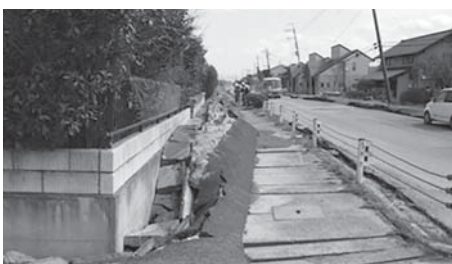
液状化による埋設配管の浮き上がり (写真：国土交通省関東地方整備局)
