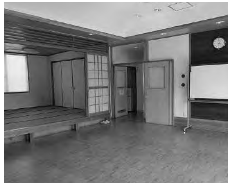
改修予定の高齢者いきいき館
