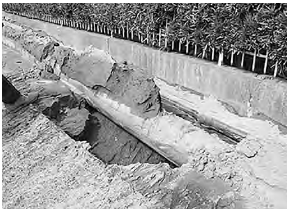
液状化による埋設配管の浮き上がり (写真:国土交通省関東地方整備局)
