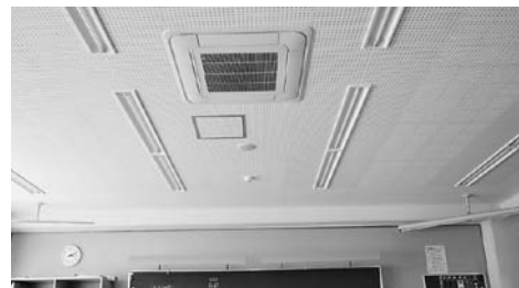
平生小学校のエアコン
