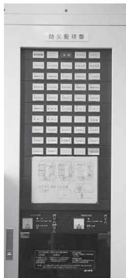
補修予定の防災監視盤（中学校）
