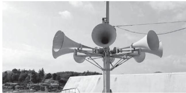
◀ 庁舎屋上のサイレン
