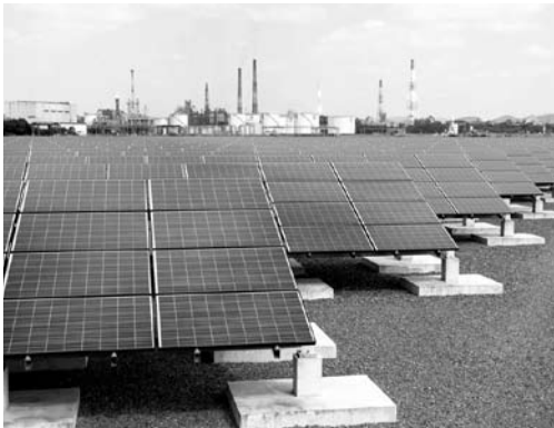
福山太陽光発電所② (中国電力提供)
