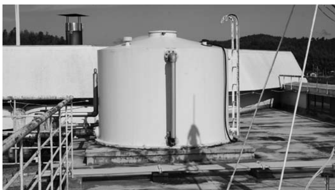
役場庁舎屋上の高架水槽
