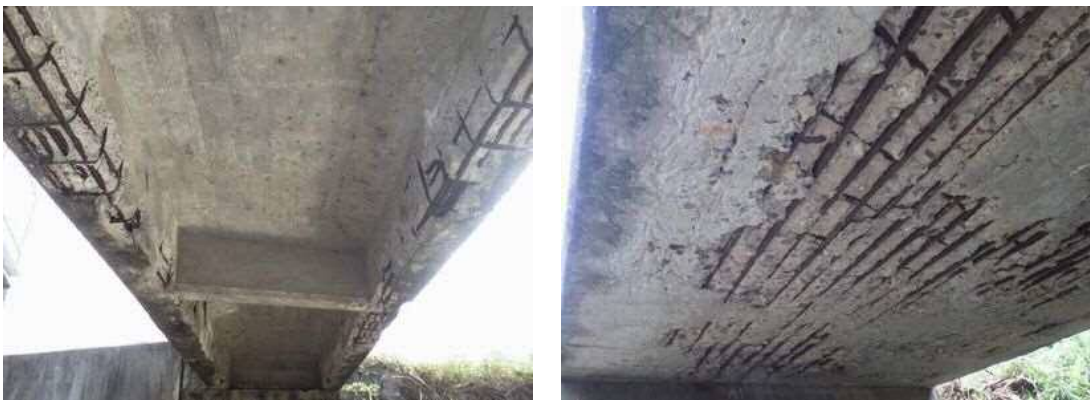
コンクリート（主桁）の剥離・鉄筋露出
